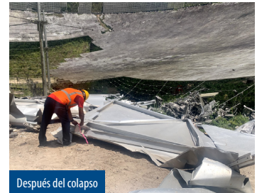
Después del colapso
