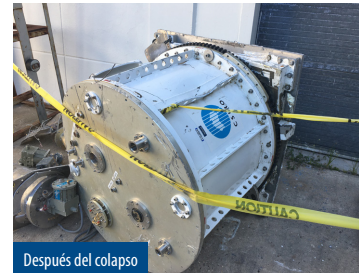
Después del colapso
