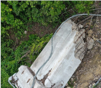
Uno de las dos piezas de la Torre 4 que cayeron por la ladera de la colina
